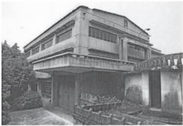
图 002：西安码头泵站主泵房
