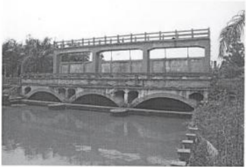
图 004：西安码头泵站节制闸
