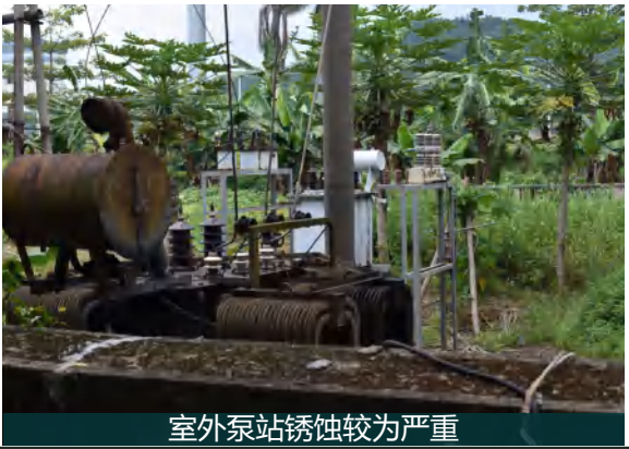
室外泵站锈蚀较为严重
