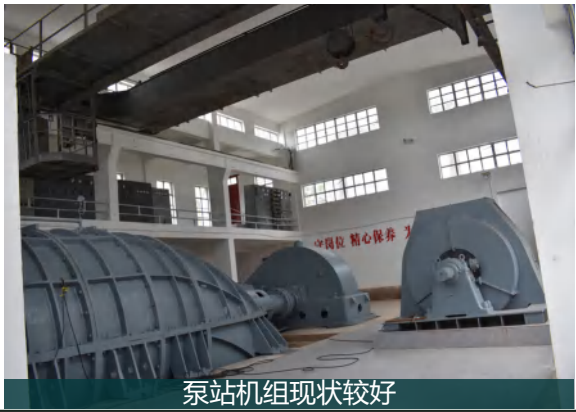
泵站机组现状较好
