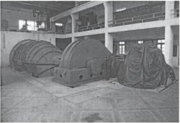
图 010：西安码头泵站卧式螺旋泵
